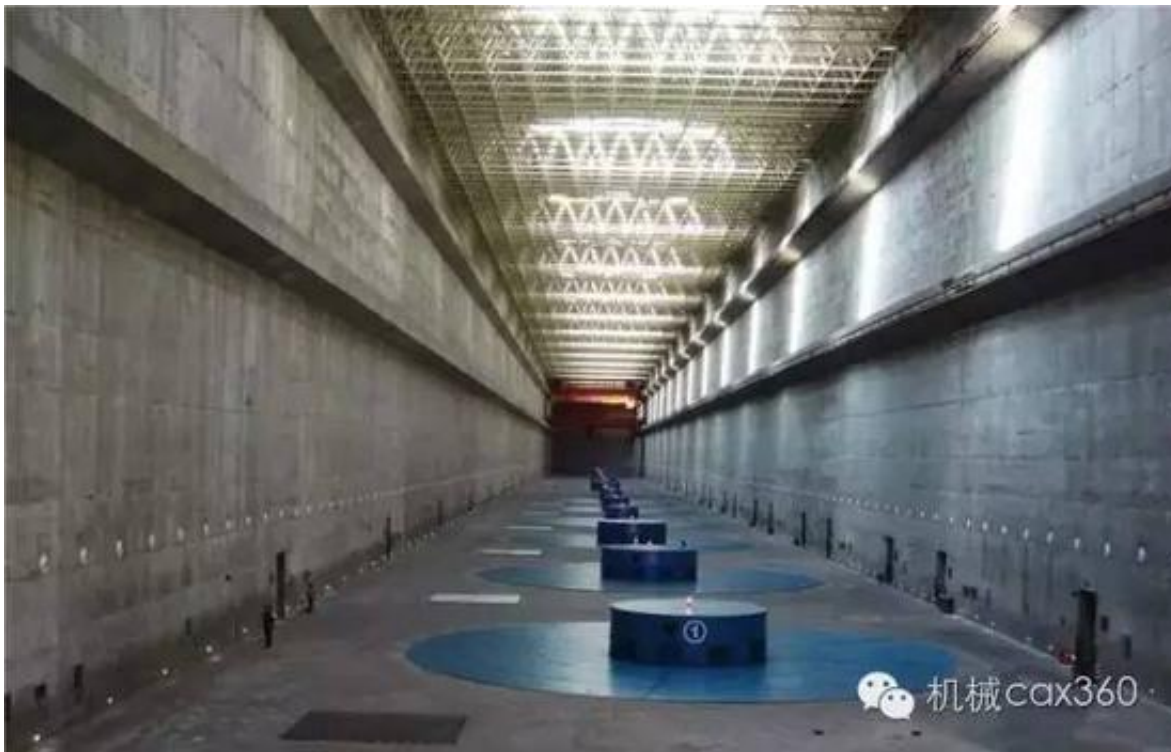
三峡电站左岸厂房机组 图片来源见水印
